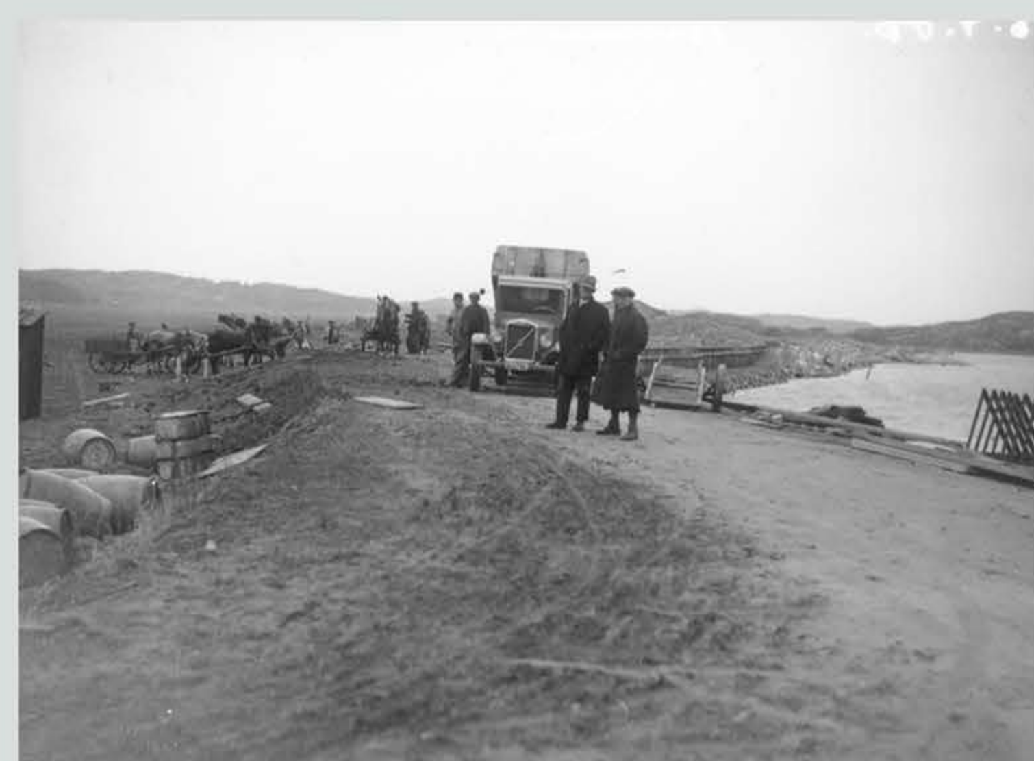
Slip/brygga: Brygga och slip fick byggas först av allt tillsammans med strandskoning för att klara transportfrågan till flygplatsen.
