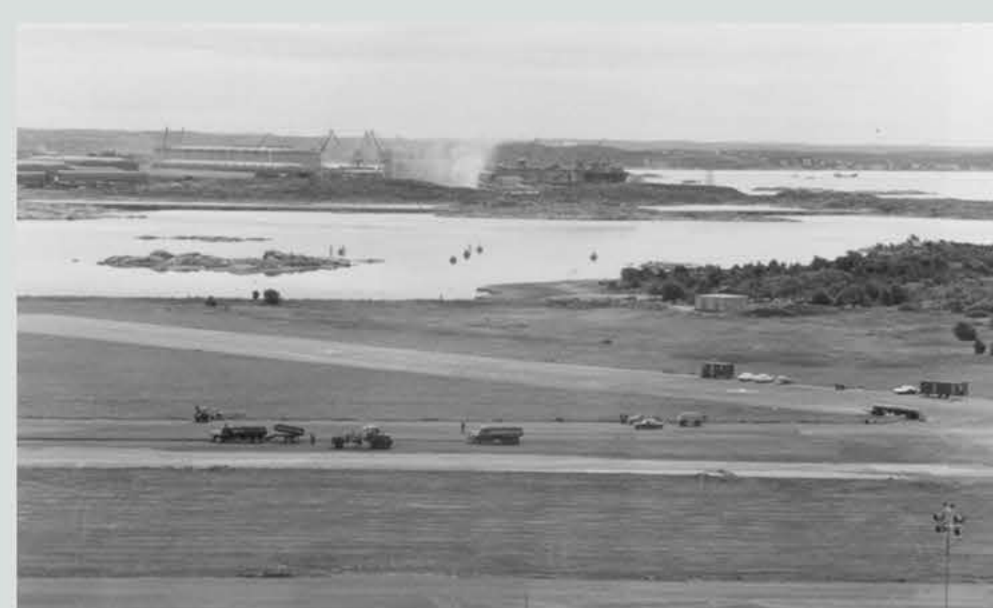
Bana 04/22 förlängdes i båda ändarna, men banan hade brister i vattenavrinning genom sättningar som skett genom åren. 1971 genomfördes därför en omfattande renovering av banan som blev avstängd under två månader. Asfalteringsarbete pågår i bilden. Tjockleken blev till slut ca 40 cm.
